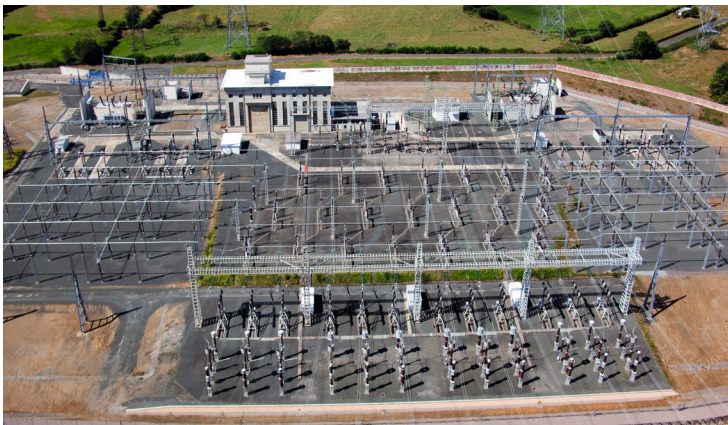
Figure 2.17 Exemples de postes électriques. En haut, un poste aérien – en bas, un poste sous enveloppe métallique
