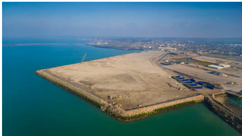
En gagnant 39ha sur la mer, Ports de Normandie dispose désormais à Cherbourg de 100 ha dédiés aux EMR, bordés par un quai lourd (15T/m 2 ) de 320m de long
